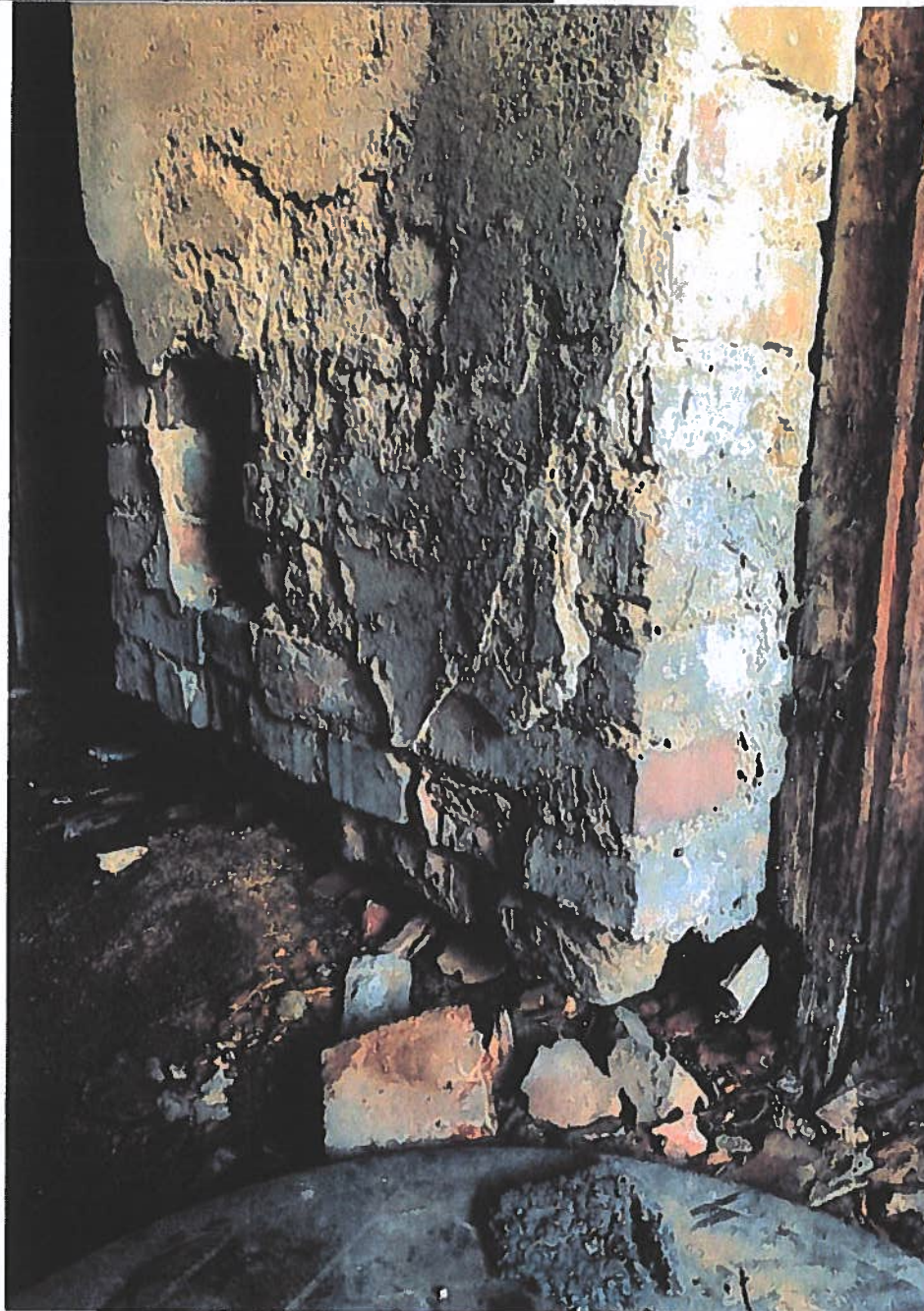
Zdj. 8 Ściany piwnicy z wejściem zewnątrz. Brak podpory ściany.
